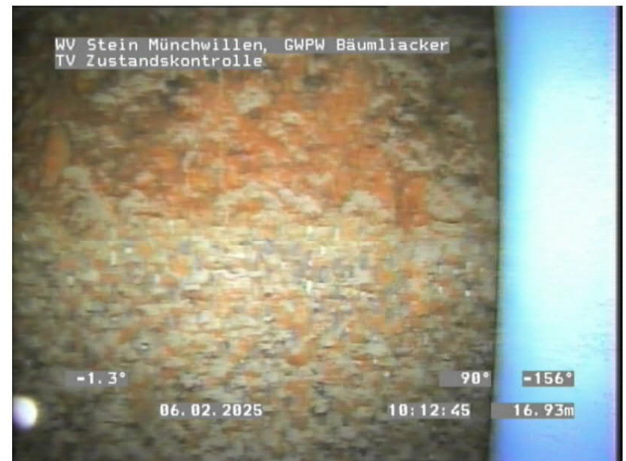
Abb. 8: Filterrohr bei 16,9 m u. MP mit Korrosion
