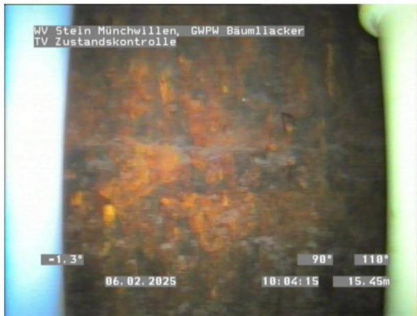
Abb. 7: Filterrohr bei 15,5 m u. MP mit Korrosion
